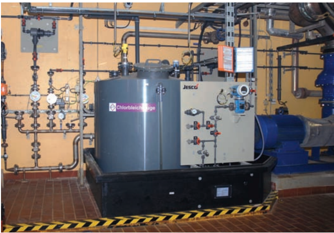
Kundenspezifische Dosiersysteme in der Industrieabwasserreinigung
