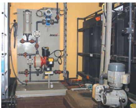
Kundenspezifisches Dosiersystem als Ersatz für eine Anlage, die fast drei Jahrzehnte mit Lutz-Jesco Pumpen im Einsatz war
