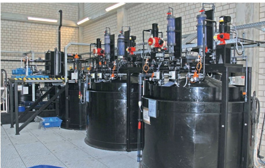
Dosieranlagen der Firma DFW Kunststoff- und Anlagenbau GmbH mit montierten MEMDOS-Pumpen
