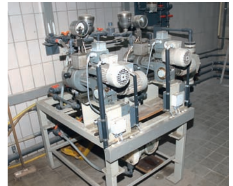
Alte Aufbereitungsanlage mit Jesco Dosierpumpen
