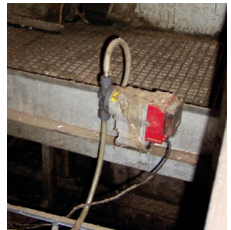
Bild 2: Dosierpumpe in einer Kunststoffrecyclingsanlage
