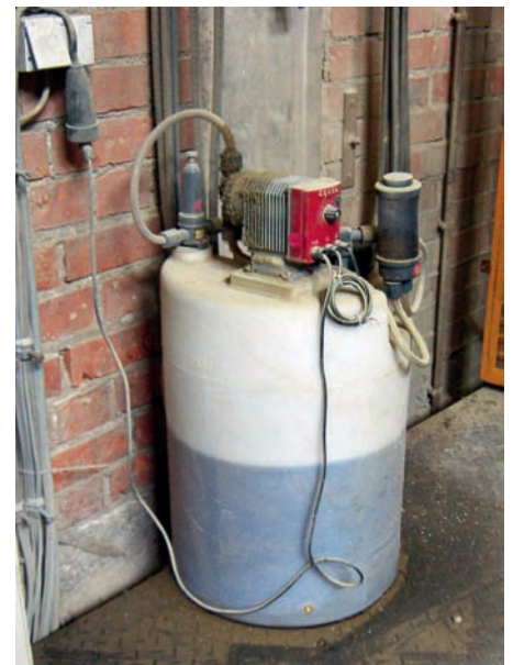
Bild 1: Dosierstation in einer Ziegelei
