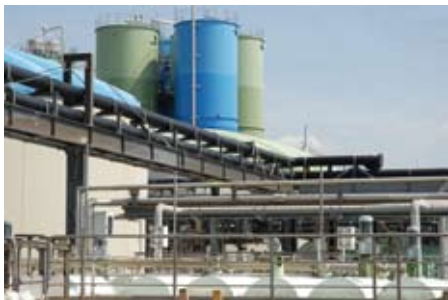
Blick auf die anaerobe Reinigungsstufe
