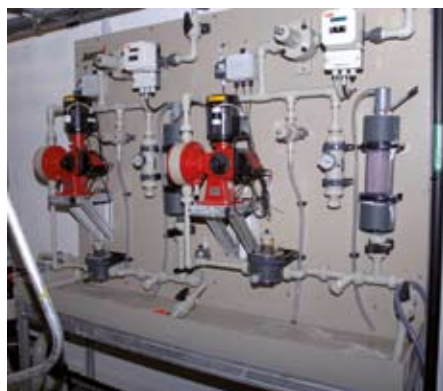
Dosiersystem mit MEMDOS DX Pumpen
