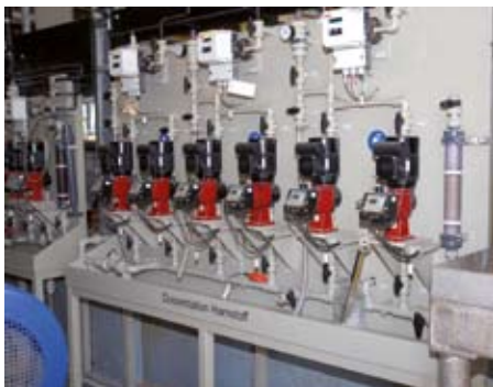
Teilanlage zur Dosierung von Nährstoffen in den Reinigungsprozess
