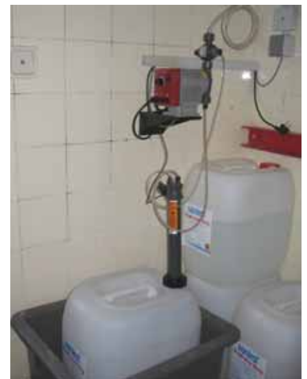
Ebenfalls im Einsatz befindet sich eine Magnet-Membrandosierpumpe MAGDOS LT und ein Multifunktionsventil PENTABLOC zur pH-Wert-Dosierung.
