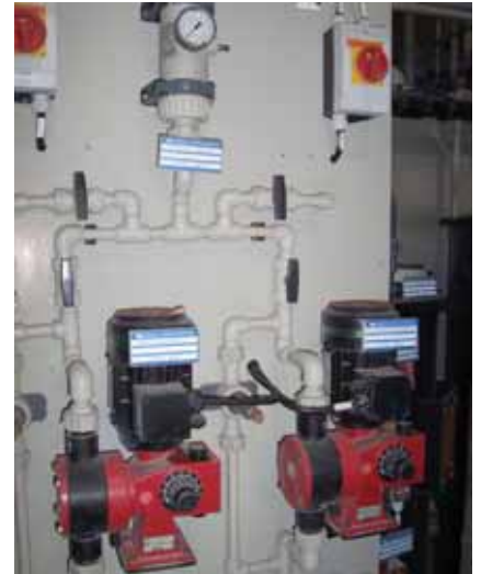
Das Bild zeigt eine Dosierstation zur pH-Korrektur mittels MEMDOS-Pumpen. Weiter einen Pulsationsdämpfer zu annähernd linearer Dosierung der Chemikalie.
