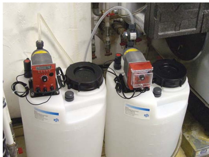
Dosierstationen bestehend aus Magnet-Membrandosierpumpen MAGDOS LT und MAGDOS DE, Behälter, Niveaurelais, Handstamper, Multifunktionsventil PENTABLOC (Bild: www.bestw-wasser.de)
