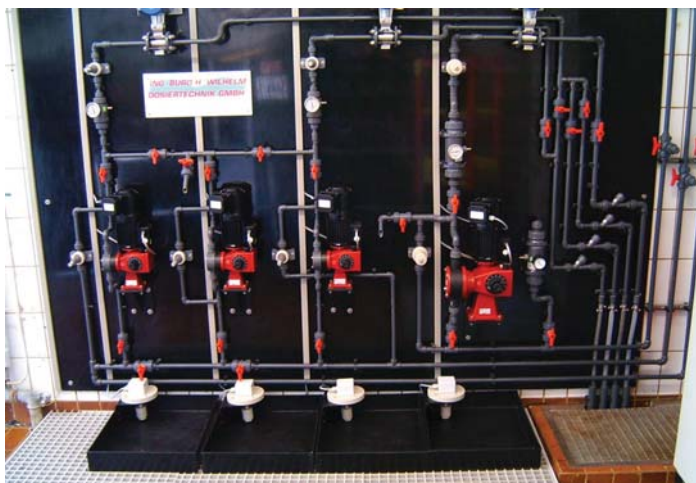
Die Dosierstation mit Lutz-Jesco Membrandosierpumpen MEMDOS E in Fürstenfeldbruck wurde Anfang des Jahres in Betrieb genommen.
